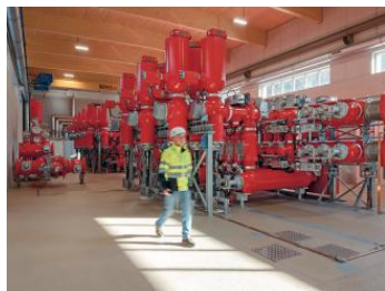
Infrastructure de réseau
