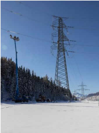
Infrastructure de réseau
