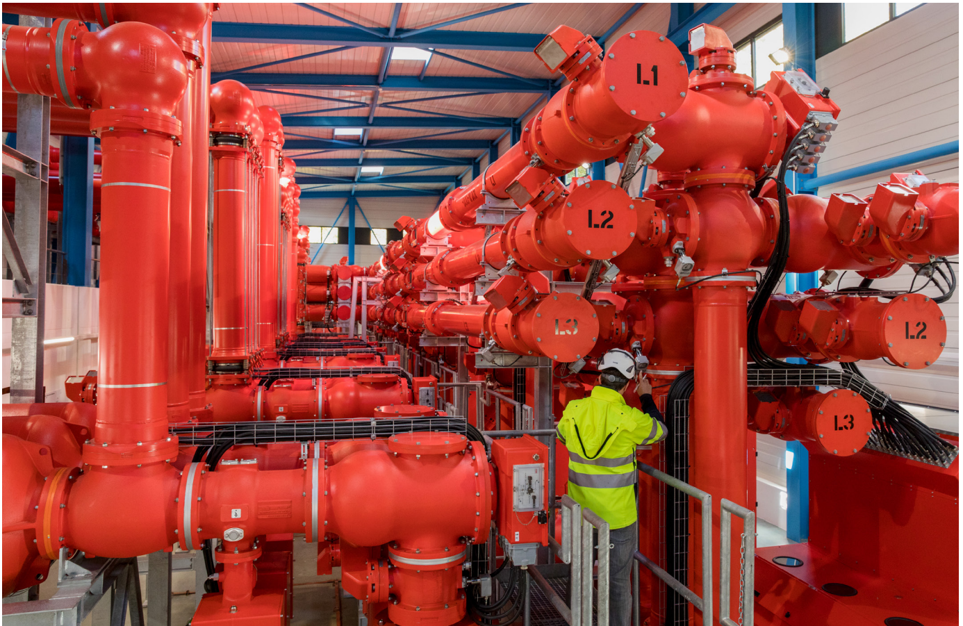
Drucküberprüfung einer Kammer der gasisolierten 220-kV-Schaltanlage in Romanel
