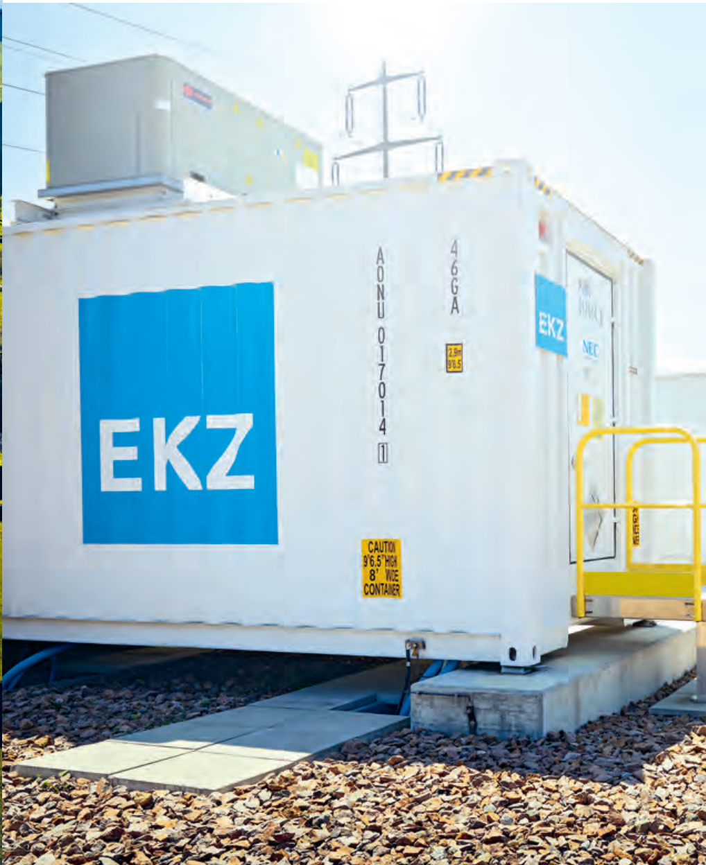
Ausbau von Speichertechnologien. Eine Grossbatterie: aussen unscheinbar, innen hightech.
