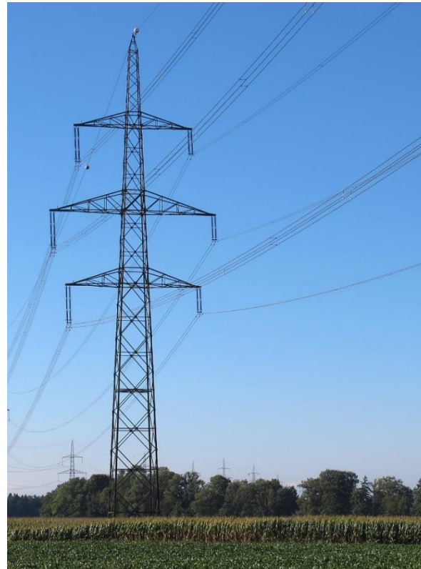
Mastbild mit Einbau Doppeltraggasse
