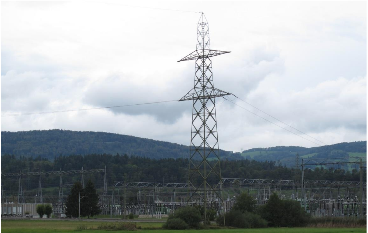
Mast Nr. 140-2: ausgelegt für einen Strang 380 kV und eine Schleife der SBB, belegt mit der 132-kV-UL Biel – Delémont
