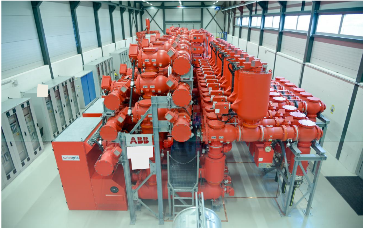
Abbildung 4: GIS-Schaltanlage (Gasisolierte Schaltanlage) Laufenburg (Foto von Swissgrid).
