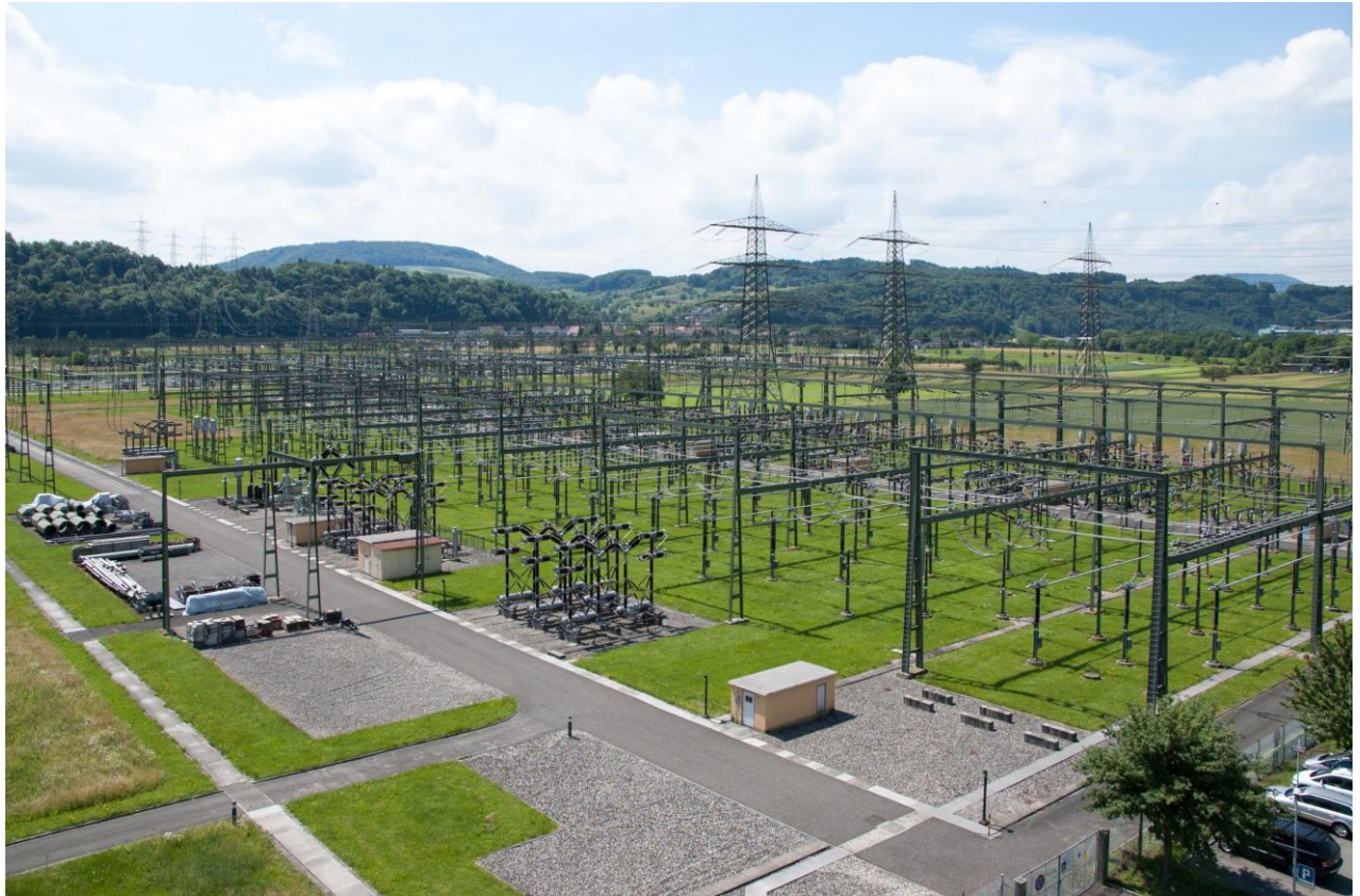
Abbildung 3: AIS-Schaltanlage (Luftisolierte Schaltanlage) Laufenburg (Foto von Swissgrid).
