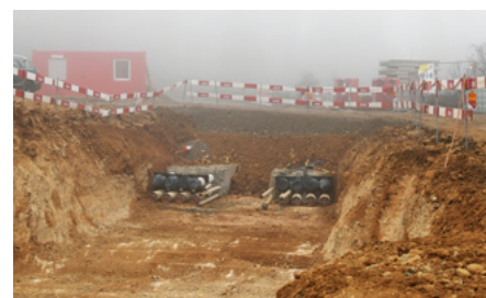
Fertig gestellter Abschnitt des Kabelrohrblocks im Gebiet «Pfaffenfirst». Gut sichtbar sind die einbetonierten Kabelschutzrohre, in welche später die Stromkabel eingezogen werden.
